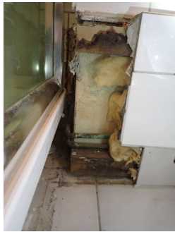
Badet har store utettheter og synlige fuktskader på overflater.
