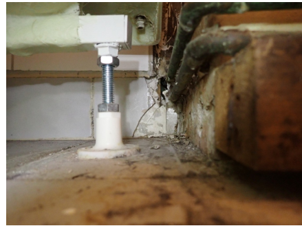
Badet har store utettheter og synlige fuktskader på overflater.
