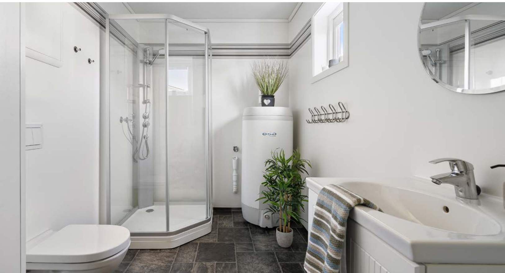
I gulvet er det varmekabler.
