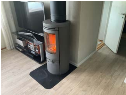
Vedovn med stålpipe.
