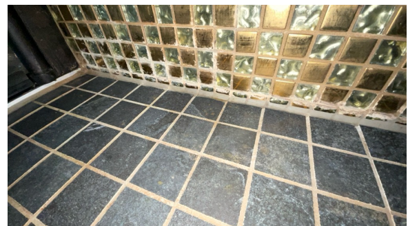
Kalkutslag i fuger neders i dusjhjørnet.
