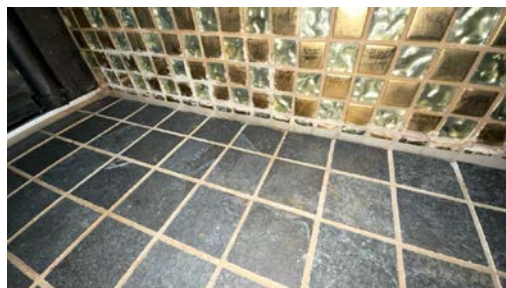
Kalkutslag i fuger neders i dusjhjørnet.
