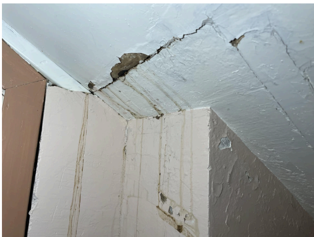
Fuktskjolder rundt gjennomføring ved pipe.
