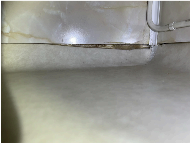
Overgang gulv/vegg ikke tett eller fagmessig utført. Overflater som er eldre enn forventet levetid.
