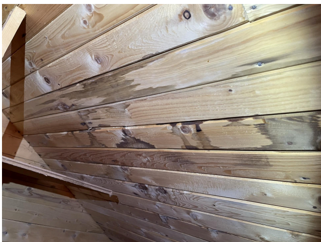
Misfarging eller skjolder (kan indikere tidligere lekkasjer).
