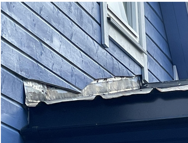
Innfestinger og overganger er mangelfulle.
