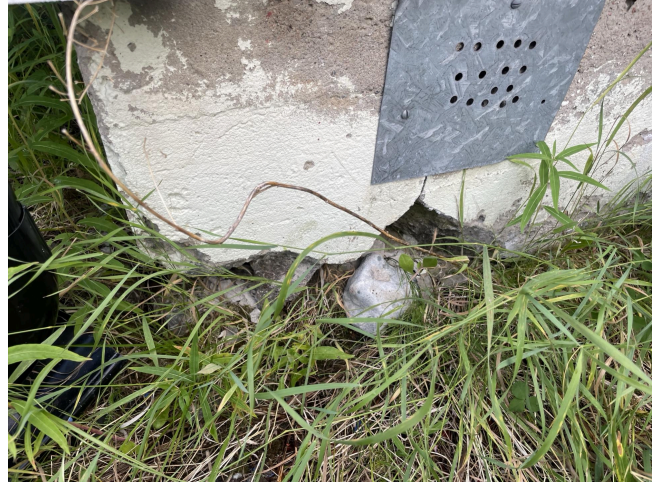
Mindre setninger og sprekker i konstruksjonen.
