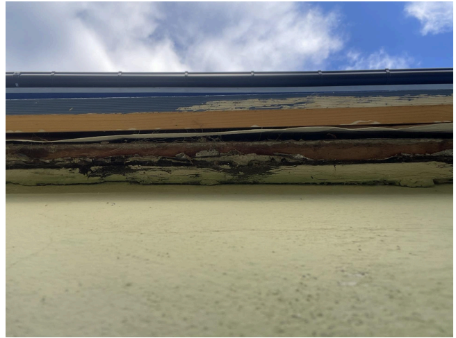
Ingen lufting i nedre kant av kledningen.
