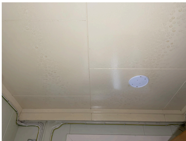
Misfarging eller skjolder (kan indikere tidligere lekkasjer).
