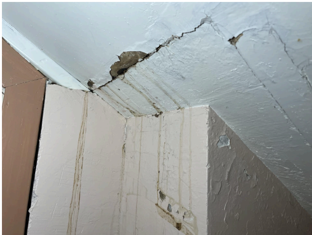
Det er registrert fukt ved gjennomføring pipe.
