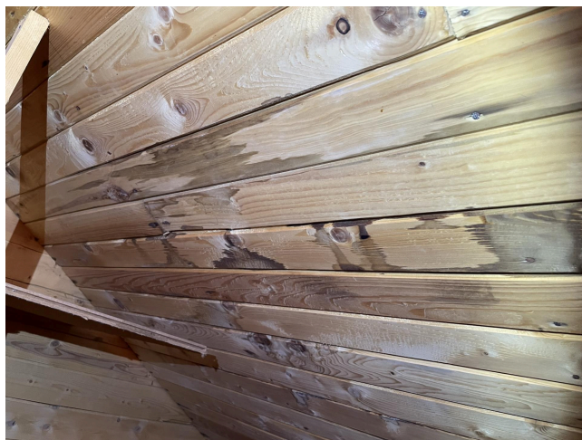
Fuktskjolder og misfarging på underside av taktro.
