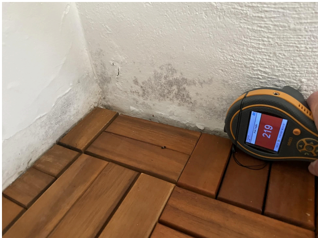
Synlig svertesopp på kjellervegg.
