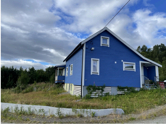
Betongsøyler/pilarer har mindre skjevstilling i vertikal retning.
