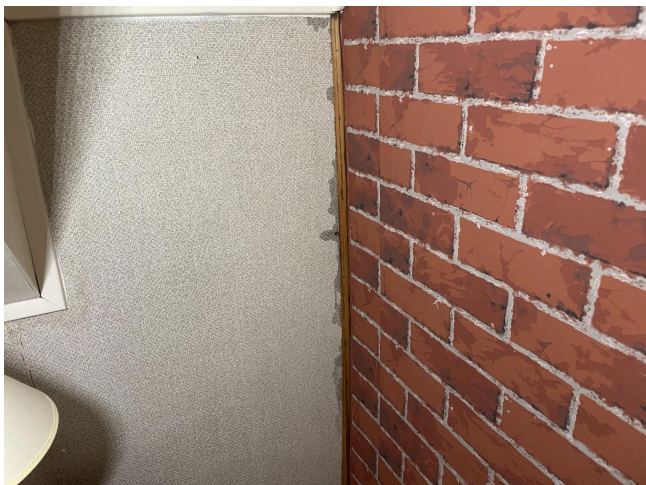
Misfarging eller skjolder (kan indikere tidligere fukt)
