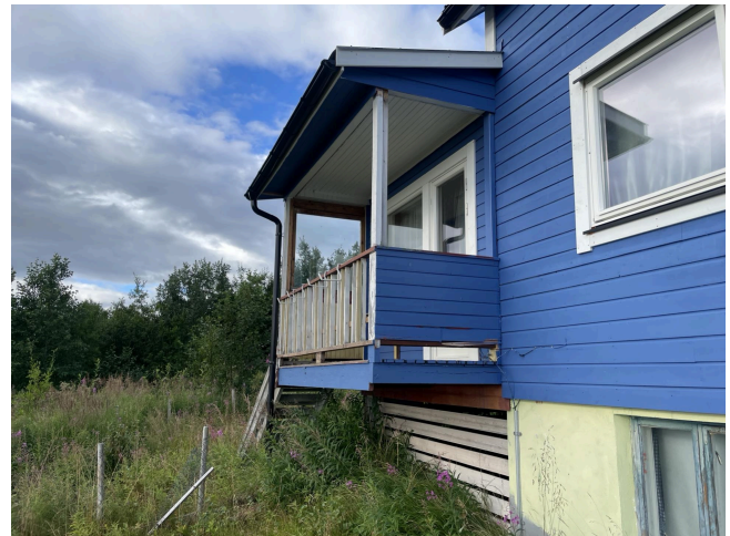
Konstruksjonene er for dårlig dimensjonert/ mangler lastnedføring til grunn.
