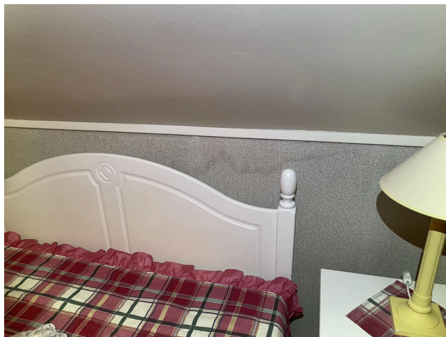
Misfarging eller skjolder (kan indikere tidligere fukt)
