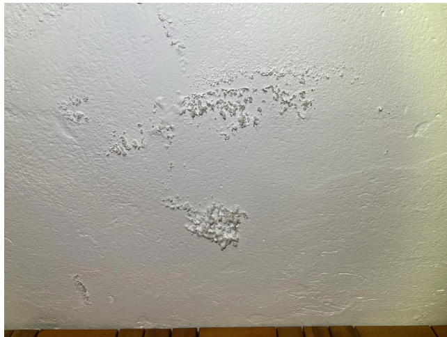
Saltutslag på kjellervegg.
