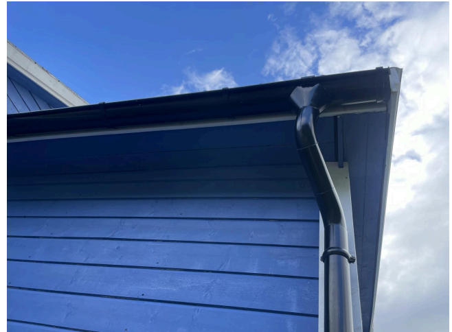
Manglende ventilering av takkonstruksjonen.
