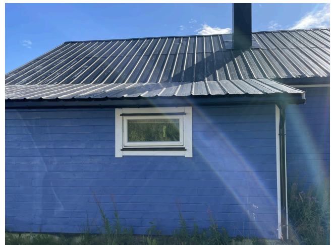
Taket er ikke inspisert på nært hold pga. manglende takstige. Taktekke er fra 1949, 1975 og 1980 – høy alder. Vedlikeholdsnivået er ikke tilfredsstillende. Innfestinger og overganger er mangelfulle.
