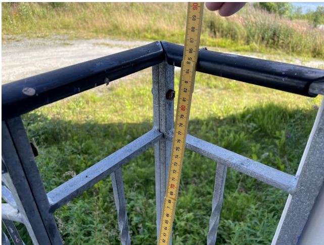
Rekkverk på veranda har ikke høyde eller utforming som tilfredsstiller dagens krav.
