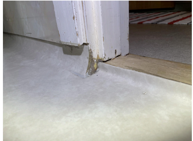
Overgang gulv/vegg ikke tett eller fagmessig utført.
