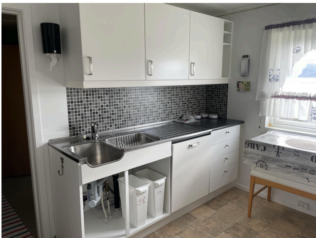
Ukjent årstall kjøkken. Eldre overflater med mindre avvik.
