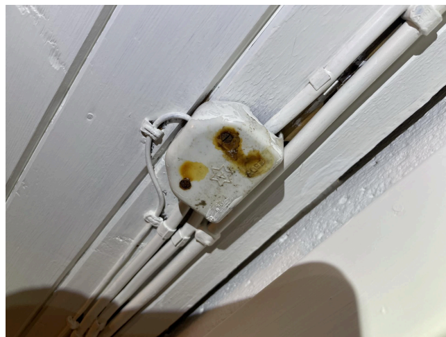
Varmgang i koblingsboks.
