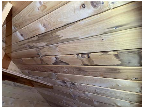
Fuktskjolder og misfarging på underside av taktro.
