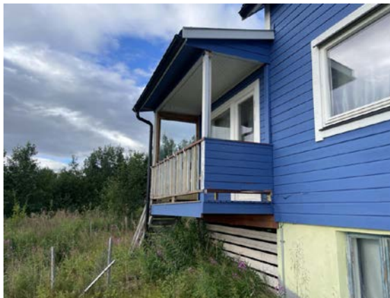
Konstruksjonene er for dårlig dimensjonert/ mangler lastnedføring til grunn.
