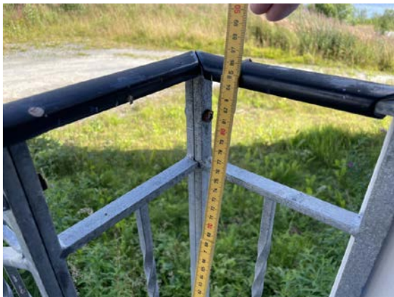
Rekkverk på veranda har ikke høyde eller utforming som tilfredsstillers dagens krav.
