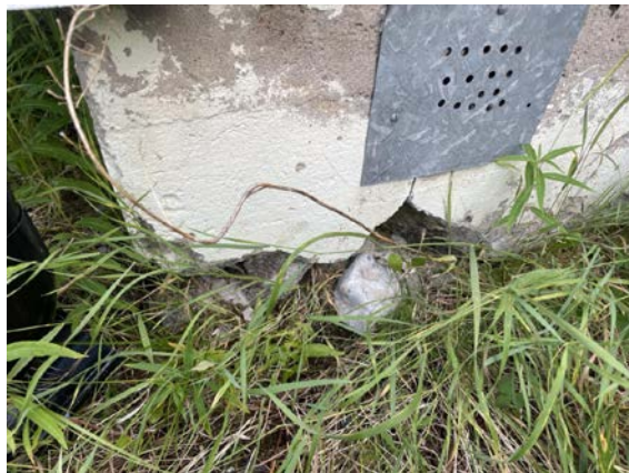
Mindre setninger og sprekker i konstruksjonen.
