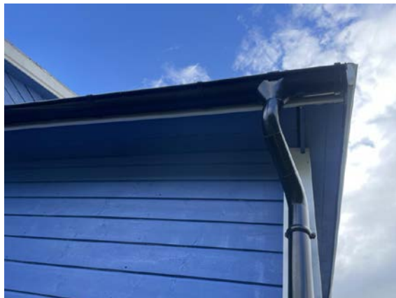
Manglende ventilering av takkonstruksjonen.
