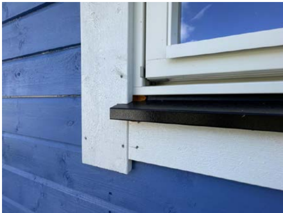
Beslag under vindu mangler oppbrett. Ingen klaring mellom sideomramming og vindusbeslag. Synlig byggskum over og under beslag.
