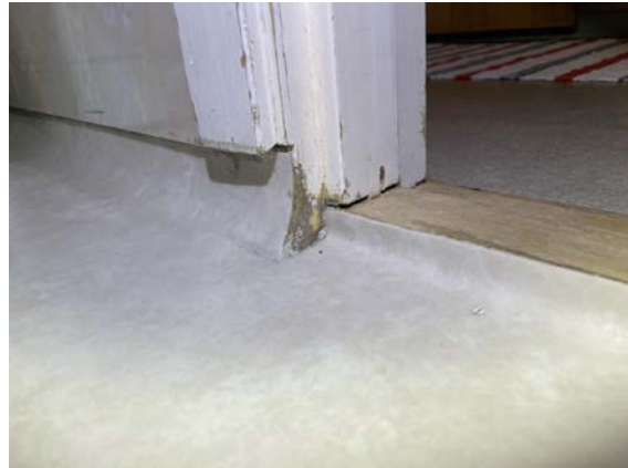
Overgang gulv/vegg ikke tett eller fagmessig utført.
