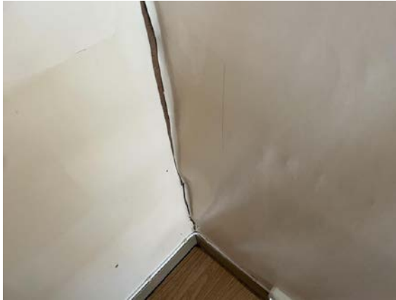
Løse eller dårlig festede tapet.
