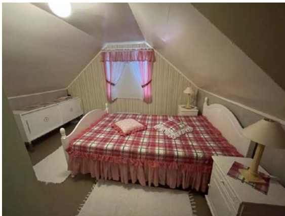
Ingen ventilasjon av soverom
