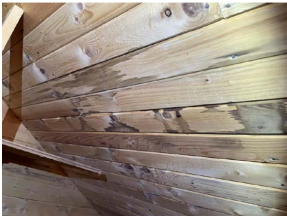
Misfarging eller skjolder (kan indikere tidligere lekkasjer).
