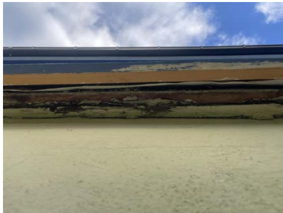
Ingen lufting i nedre kant av kledningen.
