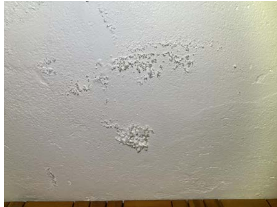
Saltutslag på kjellervegg.
