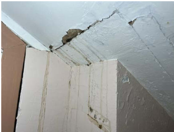
Fuktskjolder rundt gjennomføring ved pipe.
