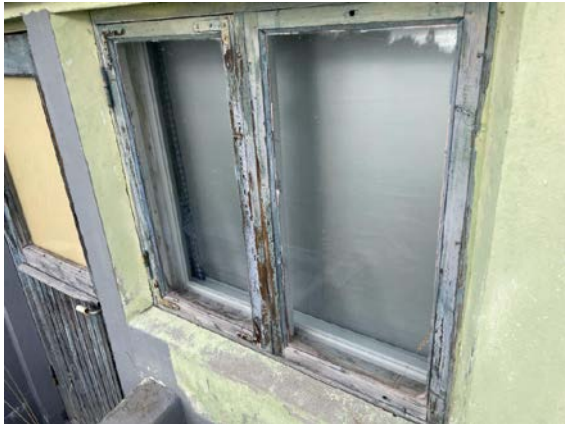
Uisolerte kjellervinduer er modne for utskifting pga. alder og tilstand.
