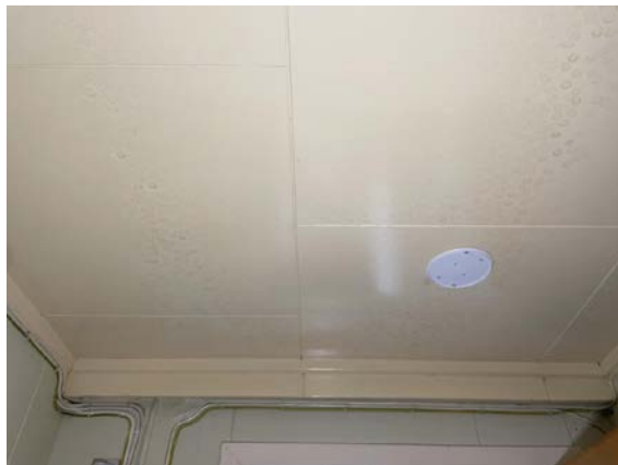
Misfarging eller skjolder (kan indikere tidligere lekkasjer).
