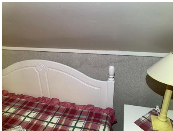
Misfarging eller skjolder (kan indikere tidligere fukt)
