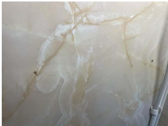
Mindre skader på baderomsplater.
