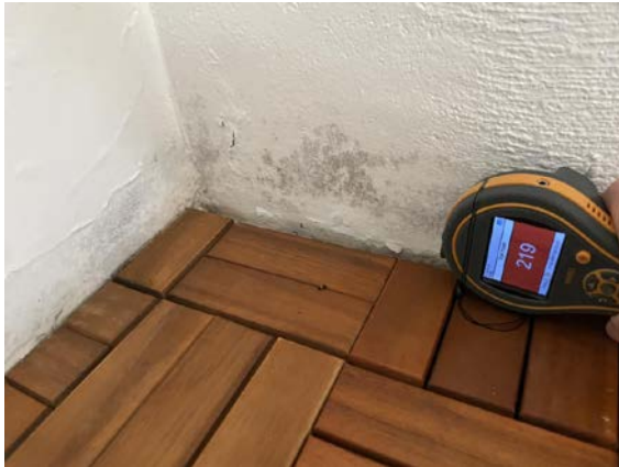
Synlig svertesopp på kjellervegg.
