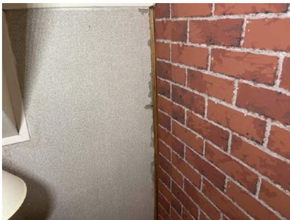
Misfarging eller skjolder (kan indikere tidligere fukt)
