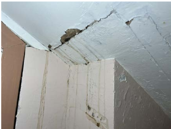
Det er registrert fukt ved gjennomføring pipe.
