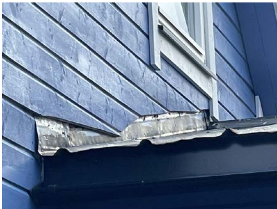
Innfestinger og overganger er mangelfulle.
