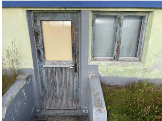
Eldre balkongdør er moden for utskifting pga. alder og tilstand.
