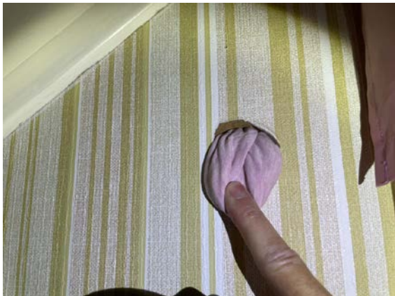
Brudd i tettesjikt ved gjennomføringer (rør, kabler, ventiler).
