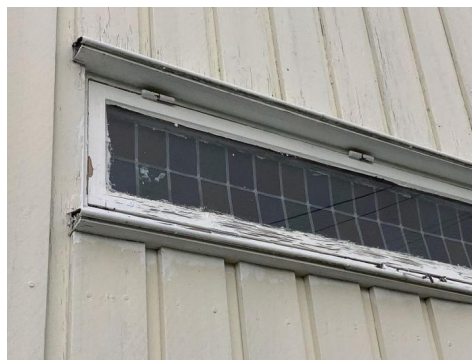
Eksempel på vindu med slitasje.
