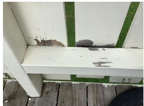
Eksempel på slitasje.
