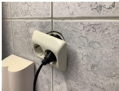
Løs stikkontakt på bad.
