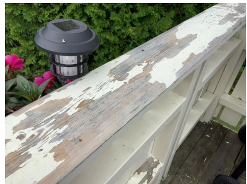
Eksempel på slitasje.
