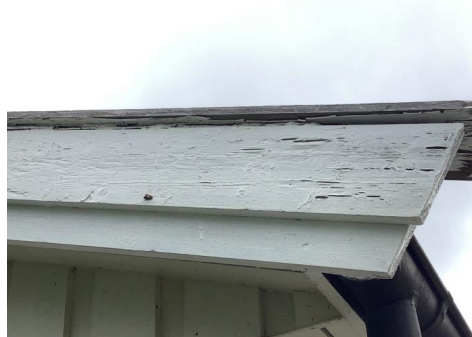
Eksempel på slitasje på vindski.
