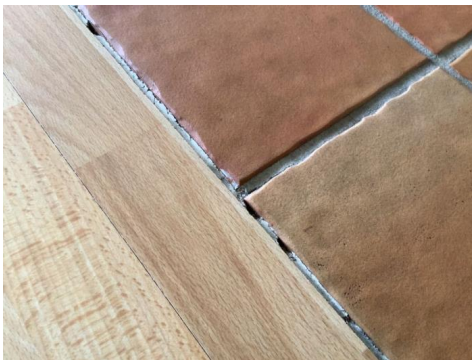
Oppsprekking i fuger på fliser.
