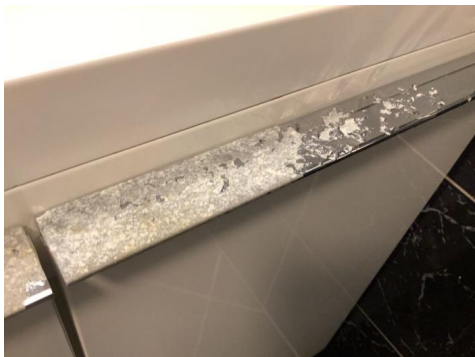
Slitasje på håndtak på innredning.
