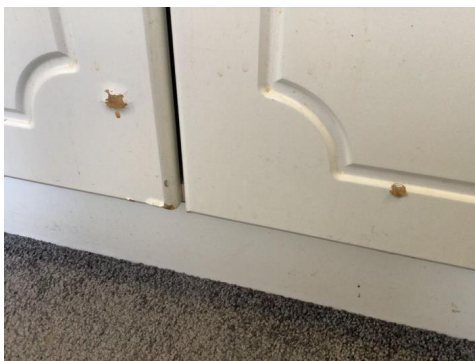
Eksempel på skader på fronter.
