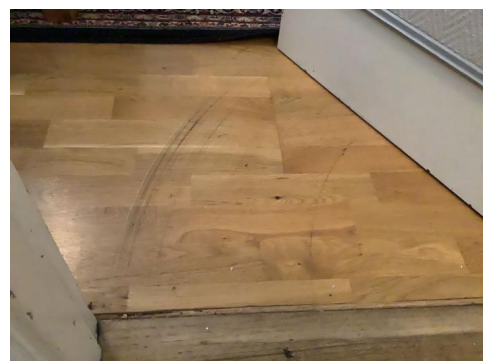
Slitasje på gult grunnet at dørblad tar i gulv.
