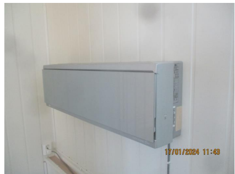
Varmepumpe i trapp.
