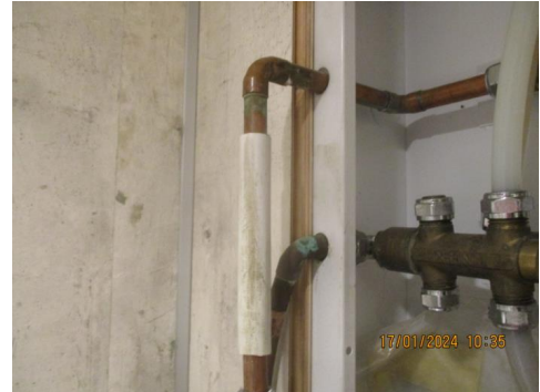
Kobberrør gjennom skapet.
