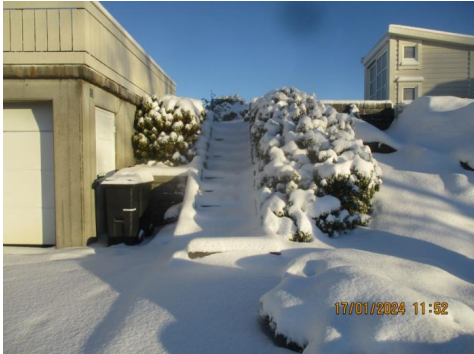
Utvendige trapper uten sikring.
