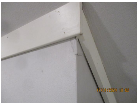
Små skader på vegg.
