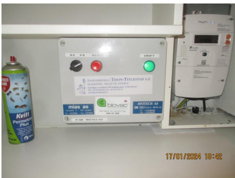
panel for minirensanlegg i entrè.
