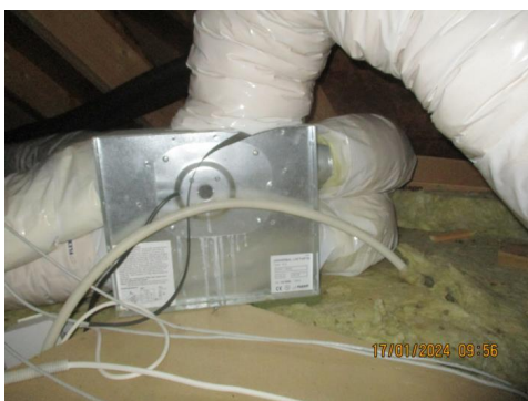
Motor for ventilasjon i knevegg. Ikke i bruk.
