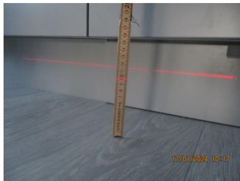
Det er målt ca. 40 mm skjevheter på gulvet i stue mot kjøkkendel.
