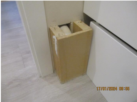
Rør til sentralstøvsuger.
