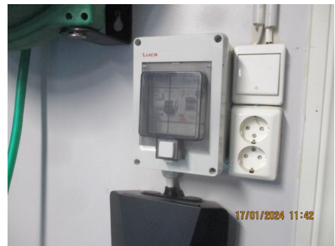
Boks med sikring i garasjen,.
