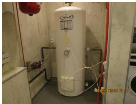
Varmtvannsbereder på vaskerom.
