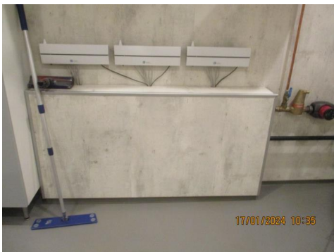
Innkasset vannbårenvarme anlegg på vaskerom.
