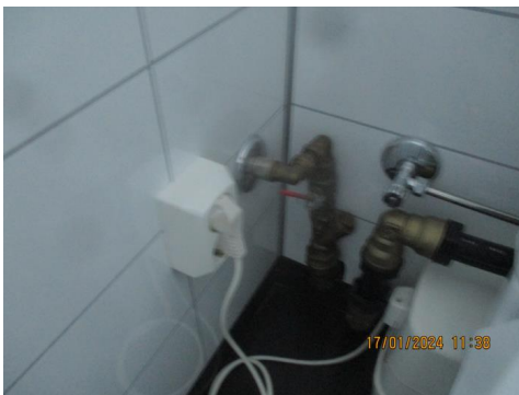
Stoppekran på toalettrom.
