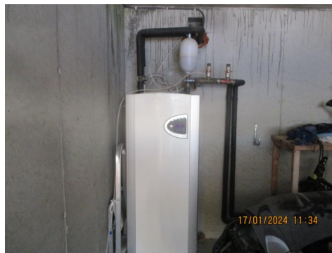
Varmepumpe i garasjen.
