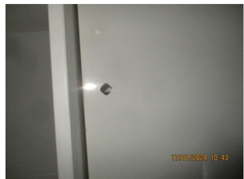
Det mangler lås til sikringskap i entré.
