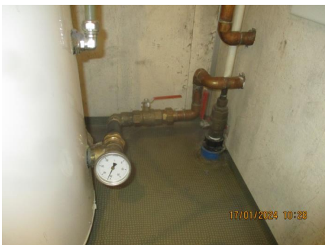
Stoppekran på vaskerom.
