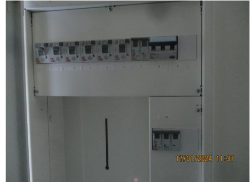
Sikringskap i entrè.
