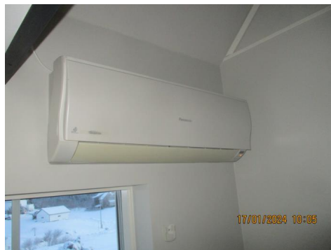
Varmepumpe i stue.
