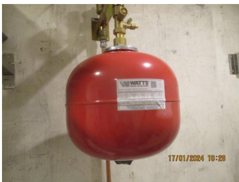
Trykktank på vaskerom.
