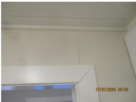
Sprekk på overfalter vegg.
