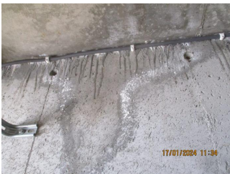
Saltutslag på vegger.
