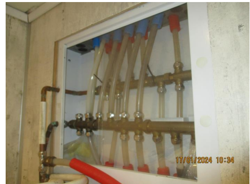
Rør i rør sentral på vaskerom.
