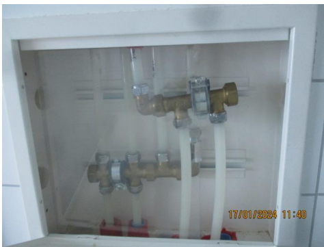
Rør i rør sentral på toalettrom.
