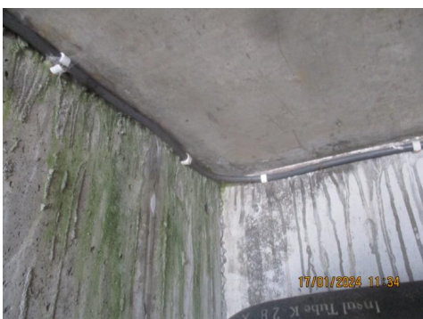
Fukt fra yttertak.
