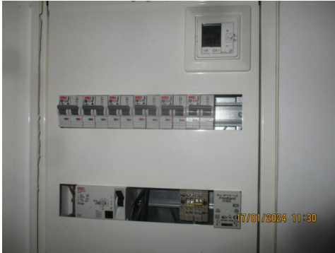
Sikringskap i entrÉ utleiedel.-
