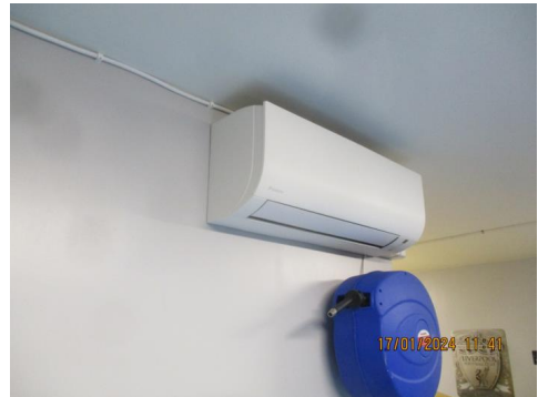
Varmepumpe i garasjen.
