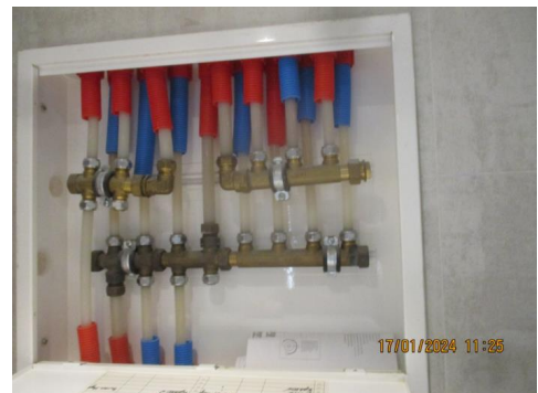
Rør i rør sentral på badet i utleiedel.
