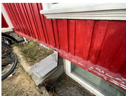
Råte i vannbord ned for kledning.
