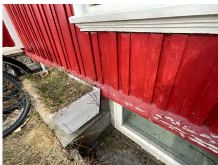
Råte i vannbord ned for kledning.
