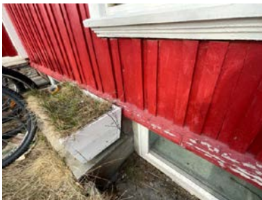
Råte i vannbord ned for kledning.
