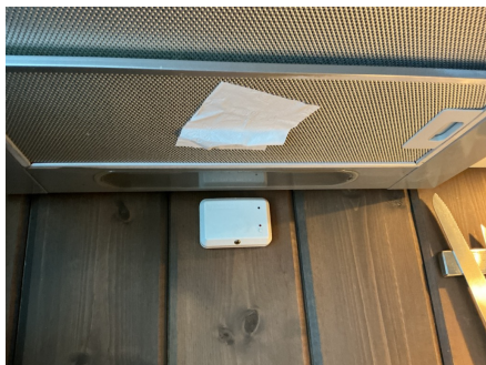
Avtrekkseffekten er testet med papir.
