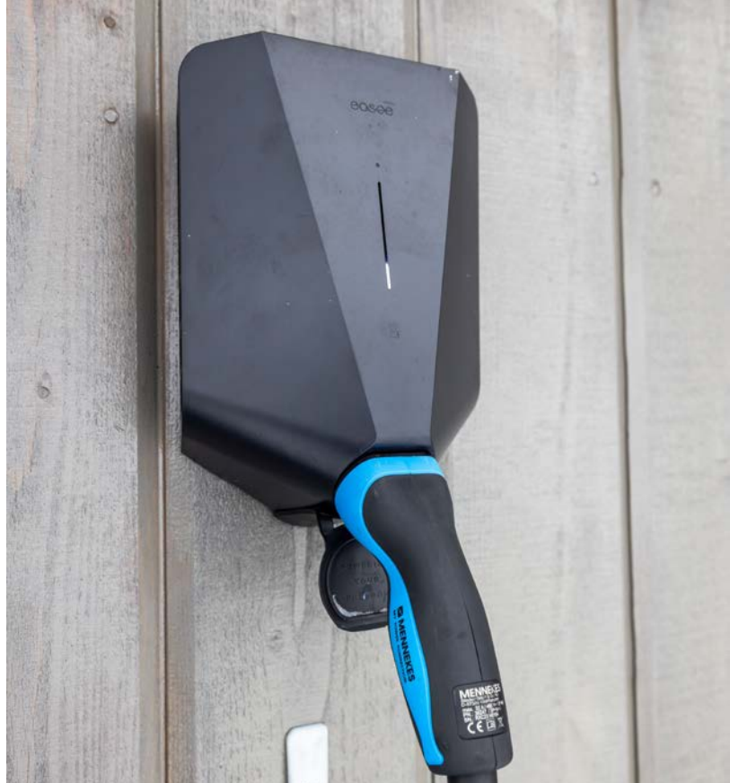
Det er montert elbillader.
