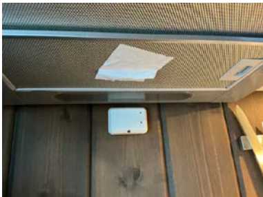
Avtrekkseffekten er testet med papir.
