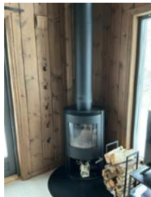
Vedovn med glassdør tilknyttet stålpipe.
