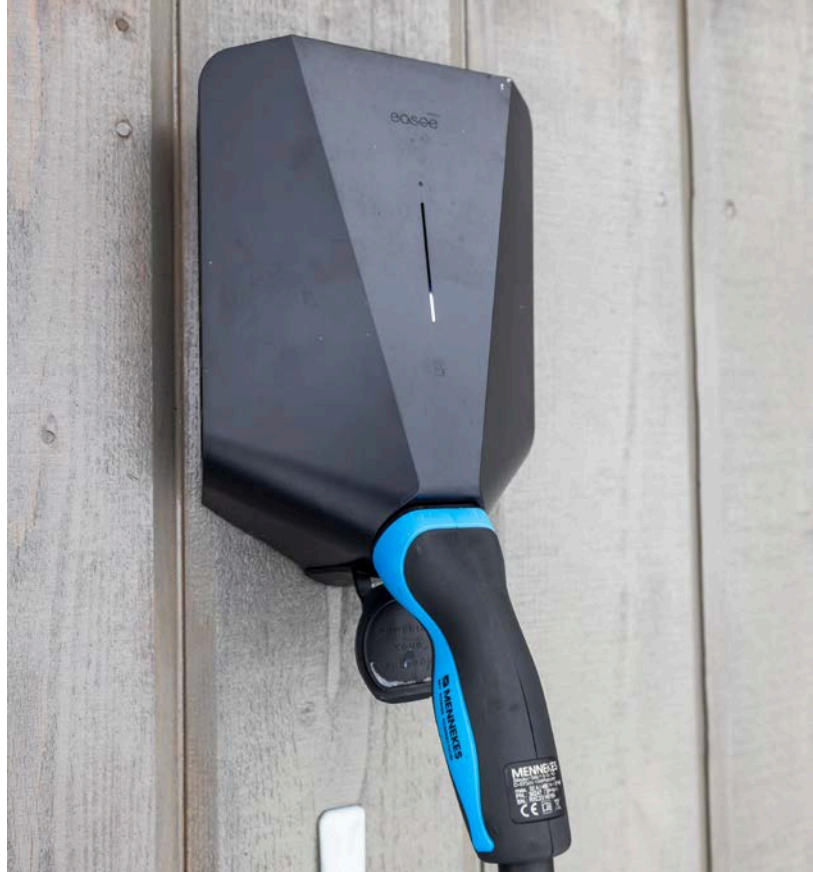
Det er montert elbillader.
