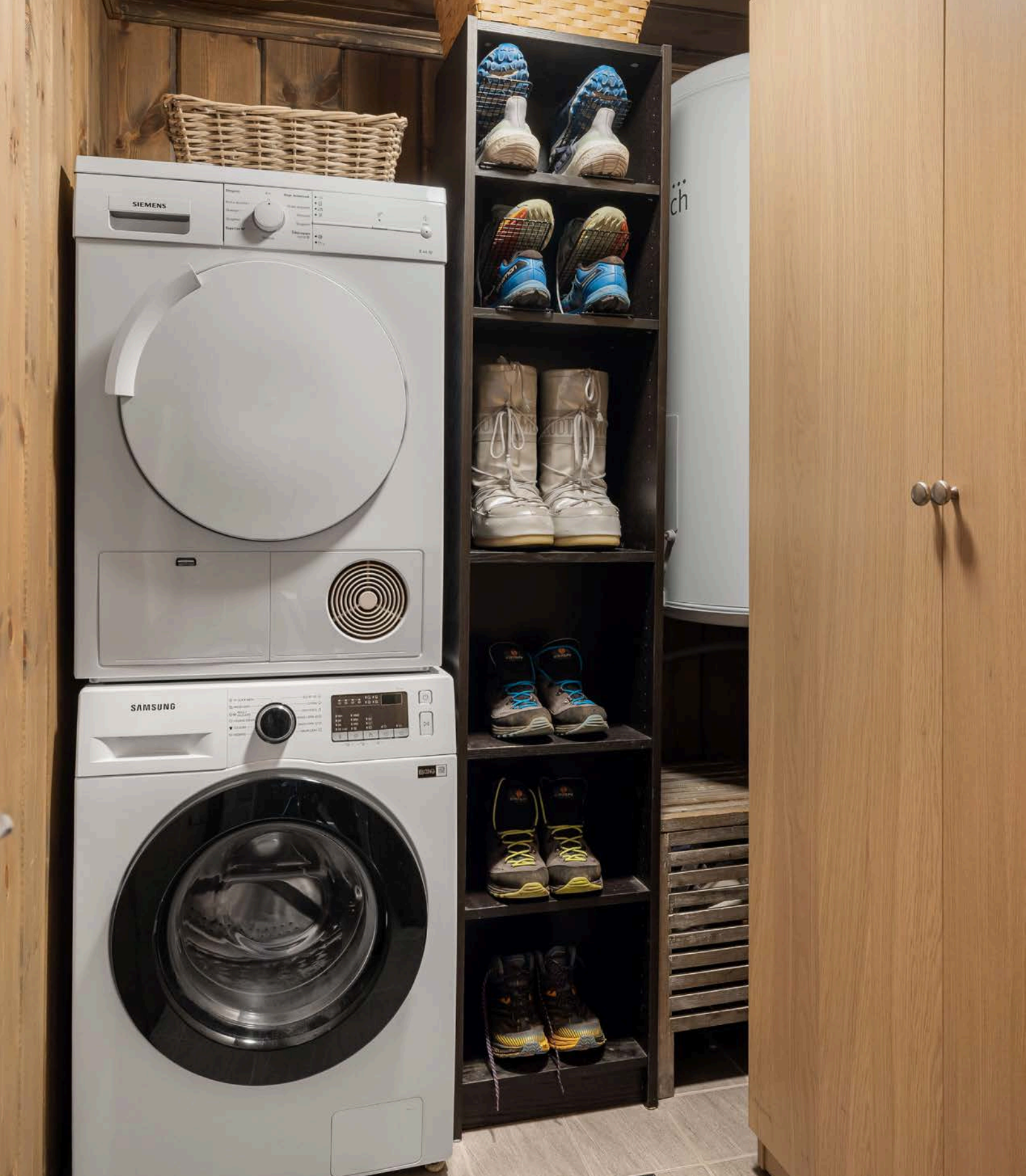
Praktisk teknisk rom/vaskerom med flislagt gulv. Det er opplegg for vaskemaskin og tørketrommel i tillegg til plass for oppbevaring.
