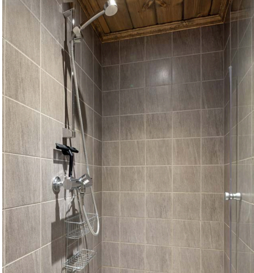
Dusjnise med dusjdør og veggmontert dusjbatteri.
