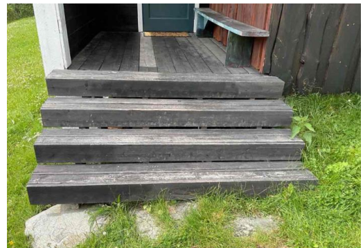
Trapp mangler rekkverk
