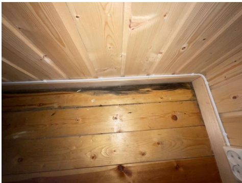
Misfarget gulv i entré.
