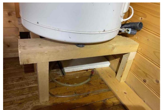
Fundament og sikkerhetsventil
