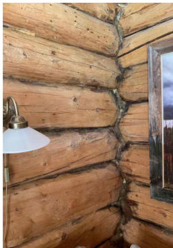
Merker etter tidligere takekkasjer
