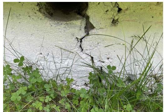
Sprekker i grunnmuren
