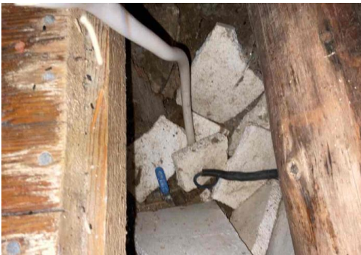
Stoppekran under bjelkelag
