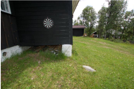
Fundament noe ute av stilling
