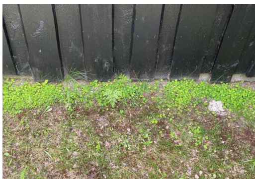
Kledningen ligger for nærme bakken
