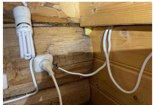
Løse ledninger og manglende isolasjon på kabel
