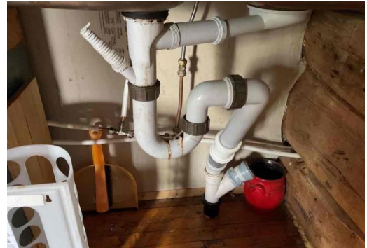
Avløpsrør i kjøkkenbenk.
