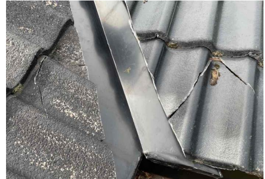
Brekkasje på taksteiner
