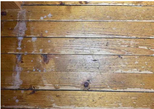
Slitemerker og skjolder på gulvet
