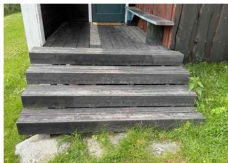
Trapp mangler rekkverk
