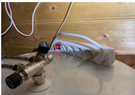
Elektrisk tilkobling på skjøtekontakt.
