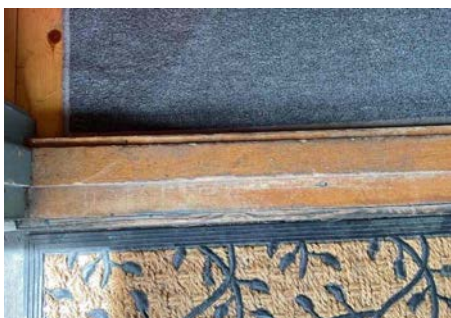
Sprekk i dørblad
