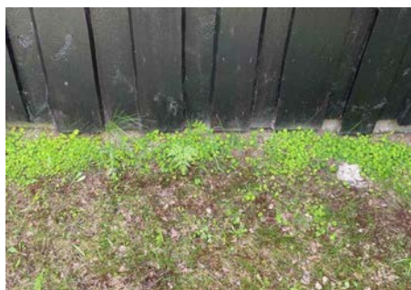
Kledningen ligger for nærme bakken
