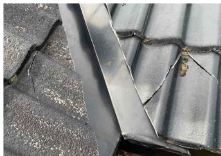
Brekkasje på taksteiner
