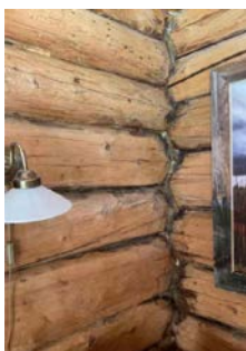
Merker etter tidligere taklekkasjer
