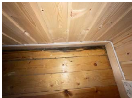
Misfarget gulv i entré.
