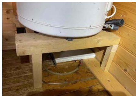
Fundament og sikkerhetsventil
