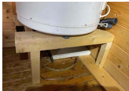
Fundament og sikkerhetsventil
