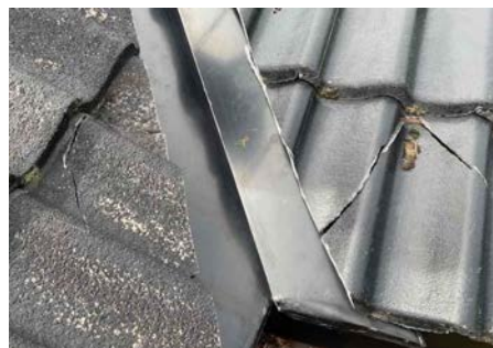
Brekkasje på taksteiner
