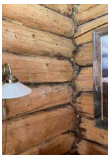
Merker etter tidligere taklekkasjer
