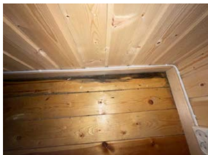
Misfarget gulv i entré.
