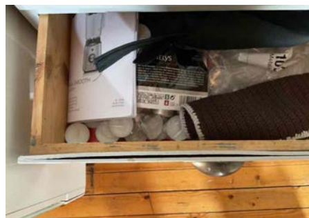
Sprekk i skuffefront ETASJE > STUE/KJØKKEN
