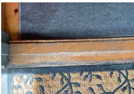
Sprekk i dørblad
