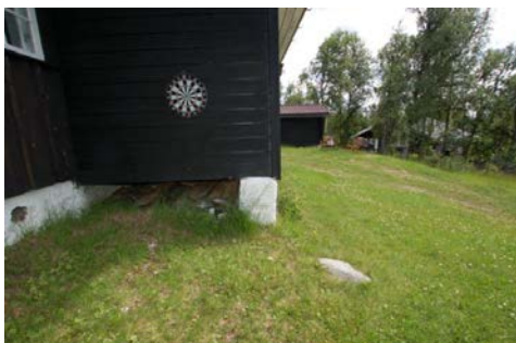
Fundament noe ute av stilling
