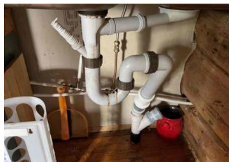
Avløpsrør i kjøkkenbenk.
