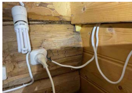
Løse ledninger og manglende isolasjon på kabel
