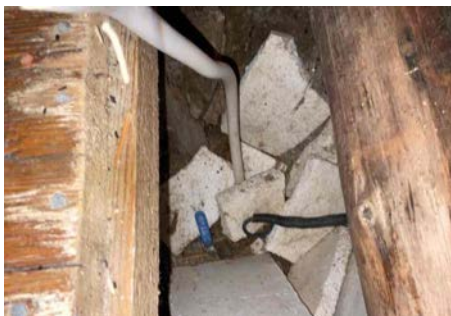
Stoppekran under bjelkelag
