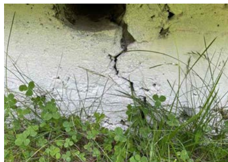
Sprekker i grunnmuren
