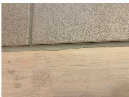
Sprekk i fuge ved nedsenk.
