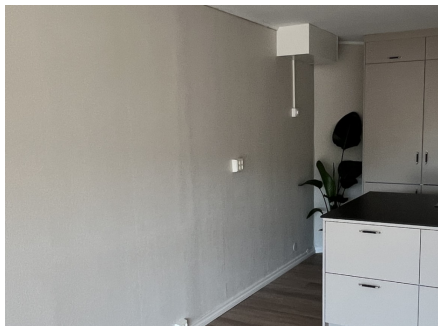
Ujevne overflater på vegg
