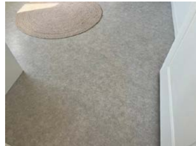
Flekk på gulvbelegg
