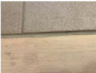
Sprekk i fuge ved nedsenk.
