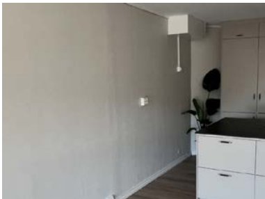
Ujevne overflater på vegg
