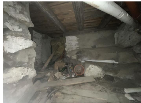
Det er manglende fuktsperre på bakken.
