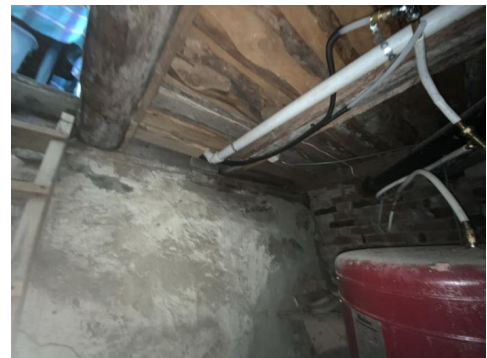
Treverk ligger direkte mot grunnmur og bør holdes under jevnlig oppsyn.
