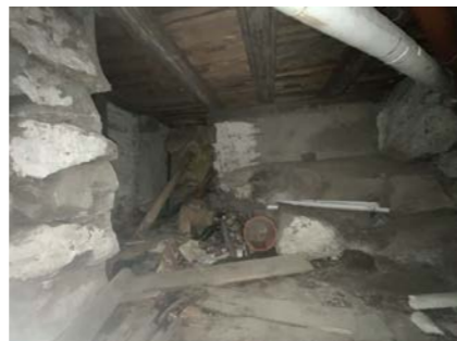
Det er manglende fuktsperre på bakken.
