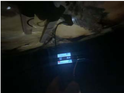
Påvist høy fuktprosent i etasjeskille i krypkjeller.
