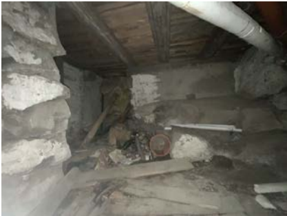
Det er manglende fuktsperre på bakken.
