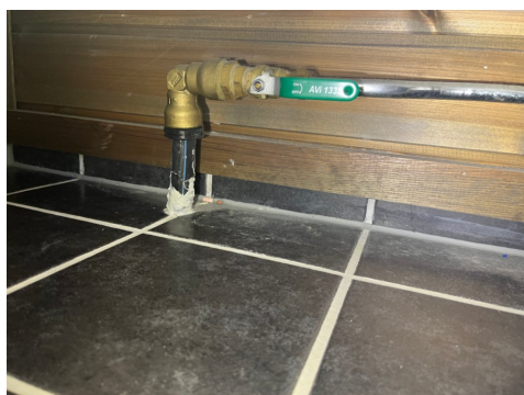
Stoppekran under servantskap.
