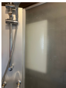
Fordelerskap bak dusjkabinett.
