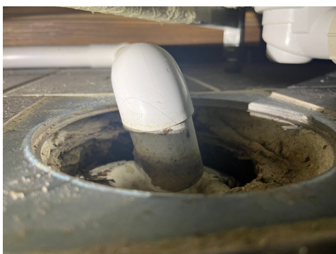
Sluk under dusjkabinett.
