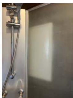
Fordelerskap bak dusjkabinett.
