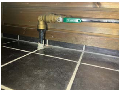
Stoppekran under servantskap.
