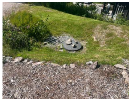
Tank for avløp.
