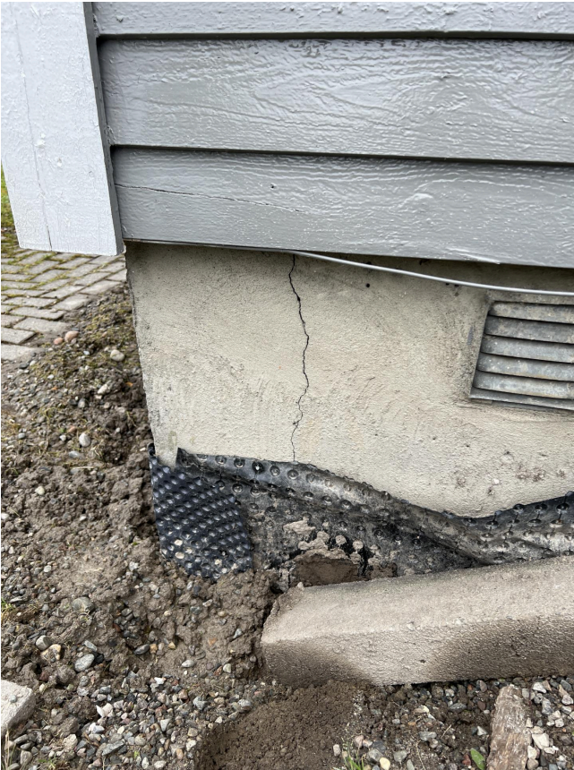
Sprekk i grunnmur.
