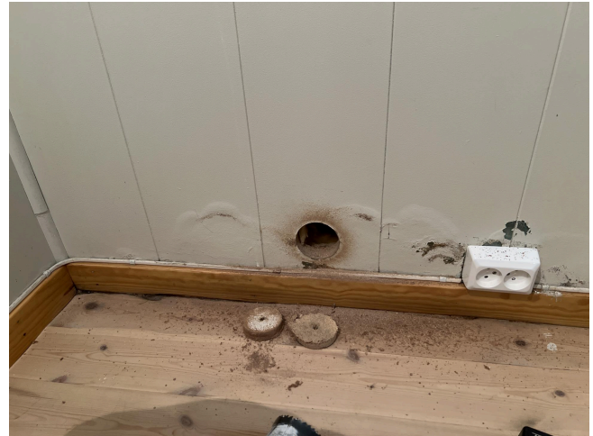
Bildet viser skader på gulv og vegg.
