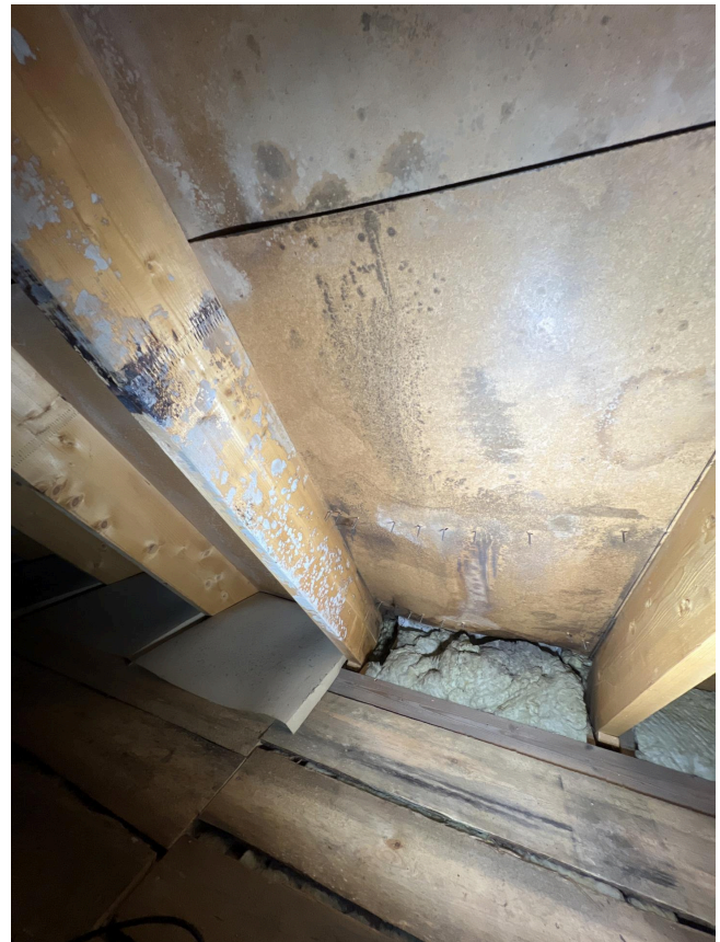
Misfarging på undertak, antas å være sotrester fra tidligere pipebrann.
