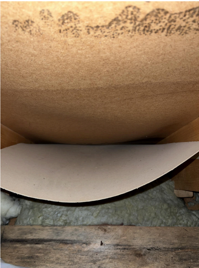
Manglende lufting mellom raftepapp/luftespalteskive og undertak.
