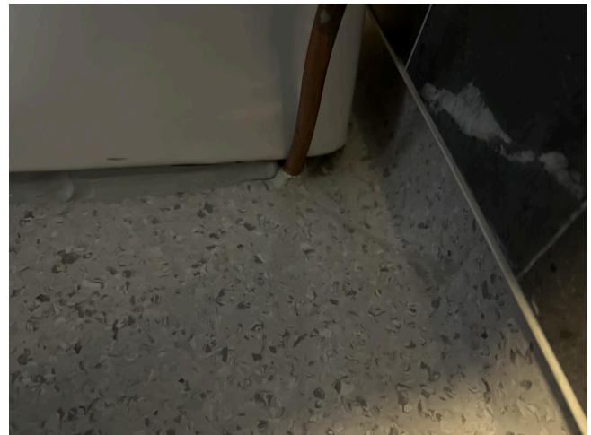
For liten oppbrett rundt rørgjennomføring.
