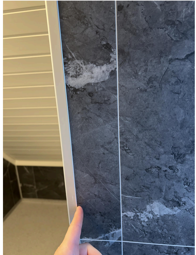
"Løst" utvendig hjørne,
