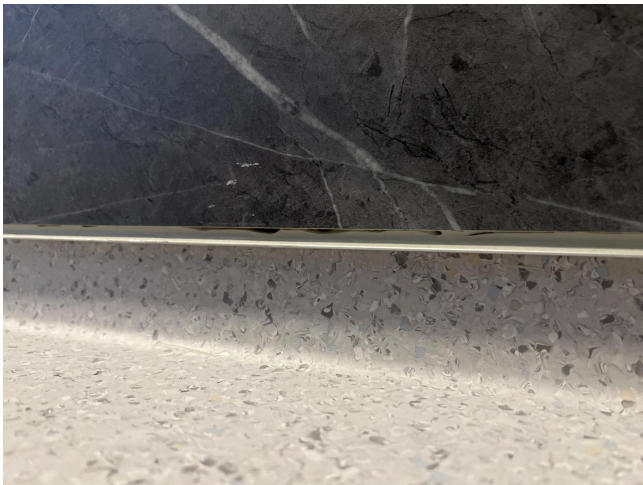
Ikke helt fullt med fugemasse mellom plate og bunnprofil.
