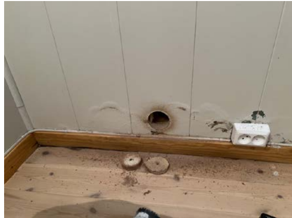
Bildet viser skader på gulv og vegg.
