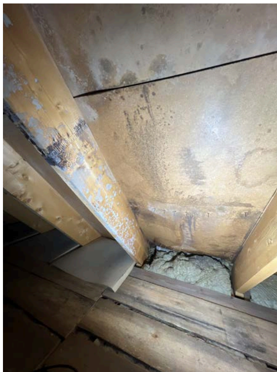
Misfarging på undertak, antas å være sotrester fra tidligere pipebrann.
