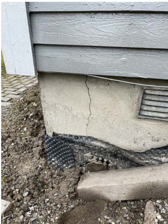
Sprekk i grunnmur.
