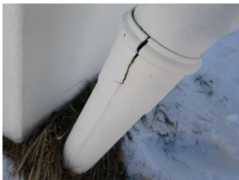
Sprekk i plastrør
