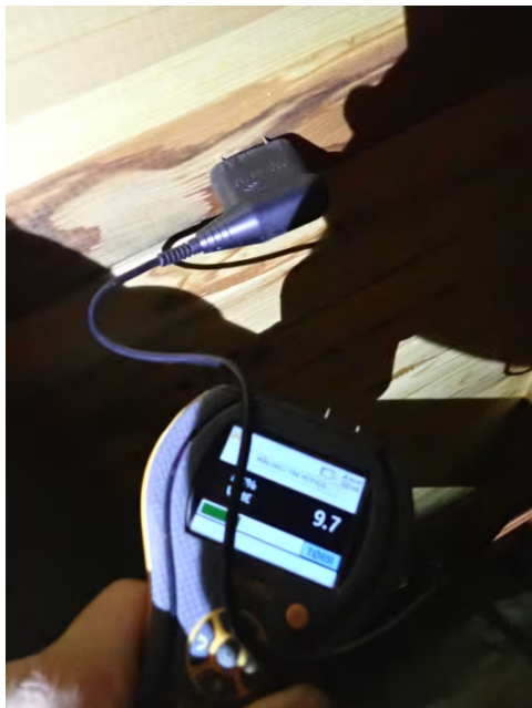
Fuktmerker ved pipe
