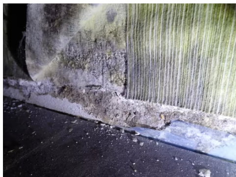
Påvist saltutslag mot dusjsone fra kott
