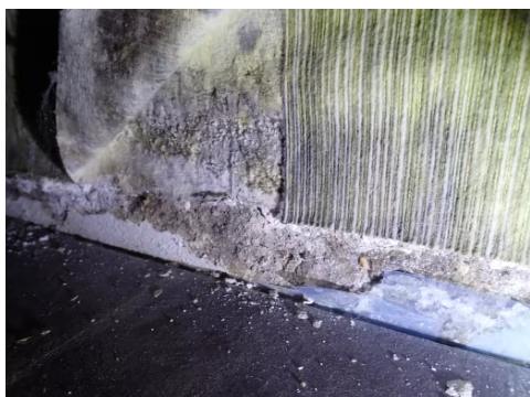
Misfarging/saltutslag i kott mot våtrom
