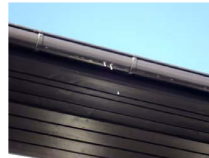
Rustflekker og symptom på drypp (istapper under renne)
