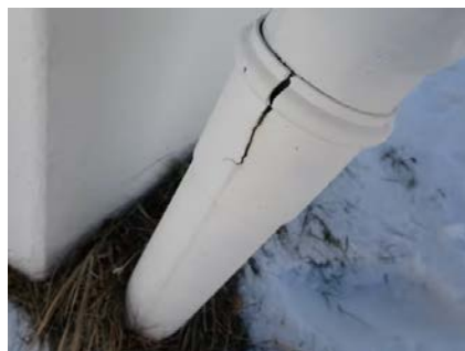
Sprekk i plastrør
