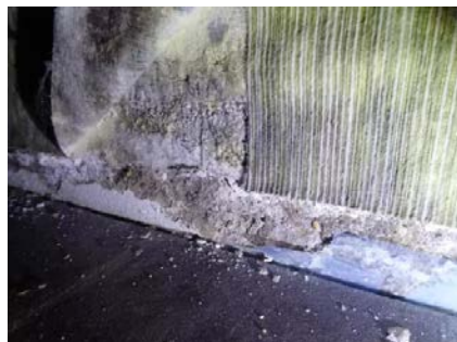
Påvist saltutslag mot dusjsone fra kott
