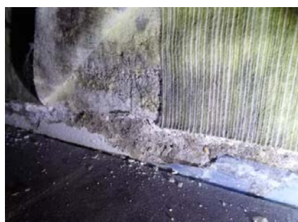
Misfarging/saltutslag i kott mot våtrom
