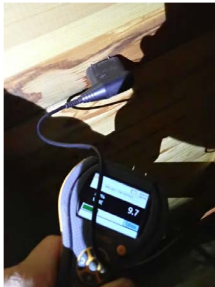
Fuktmerker ved pipe
