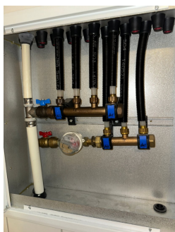
Samleskap med rørkurser og stoppekraner
