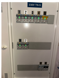
Sikringsskap med automatsikringer.
