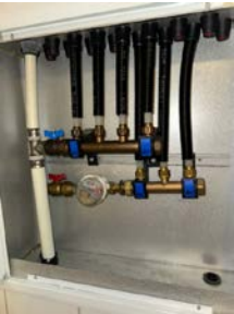
Samleskap med rørkurser og stoppekraner
