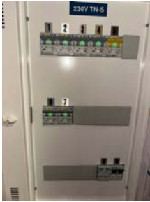
Sikringsskap med automatsikringer.
