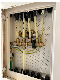
Rørskap plassert i vegg på badet
