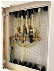
Rørskap plassert i vegg på badet
