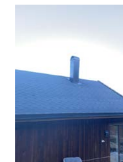
Manglende takstige opp til pipeløp
