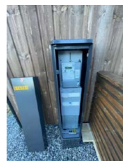
Utvendig hovedskap med overspenningsvern, AMS Strømmåler og hovedsikring på 63 AMP
