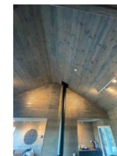
Brannmelder i himling på stue
