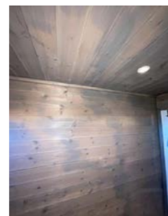
Noe ujevn overflatebehandling på beising av panel
