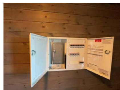
Sikringsskap på soverom
