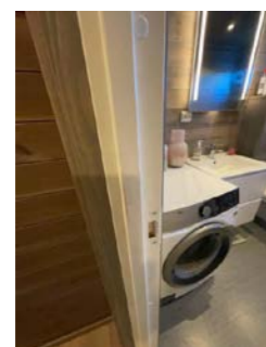
Overflateskade på dørkarm ved bad
