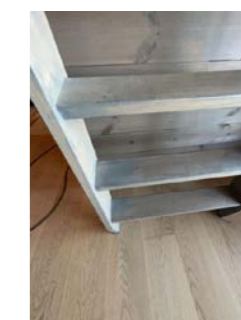
Noe bruksmerker i overflate på trinn
