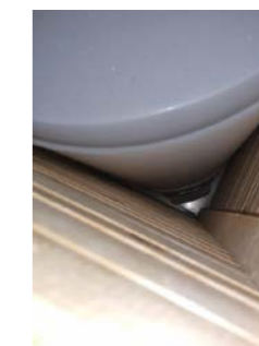
Bildet viser ned mot sikkerhetsventil som er ført ned i oppsamlingskar
