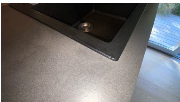
Skade på hjørne av vask
