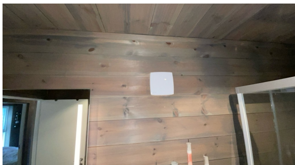
Mekanisk avtrekk på vegg
