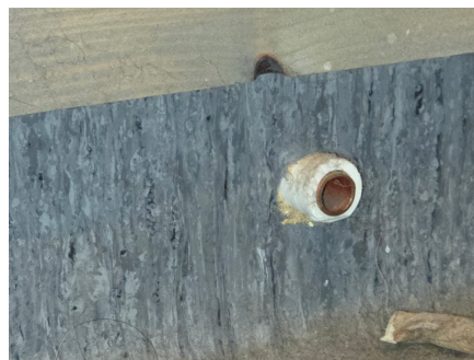
Utløpsrør fra varmtvannsbereider er synlig inne på bad bak vaskemaskin
