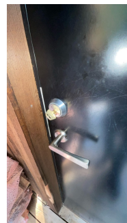
Merker på dør ved dørvrider og lås ytterdør
