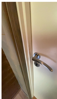
Overflateslitasje på dørkarm bad
