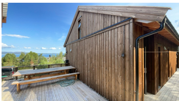
Overflatebehandling av gavellvegg må påregnes
