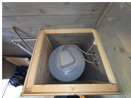
Oversikt varmtvannsbereider som er kledd inn med panel og løst lokk for inspeksjon
