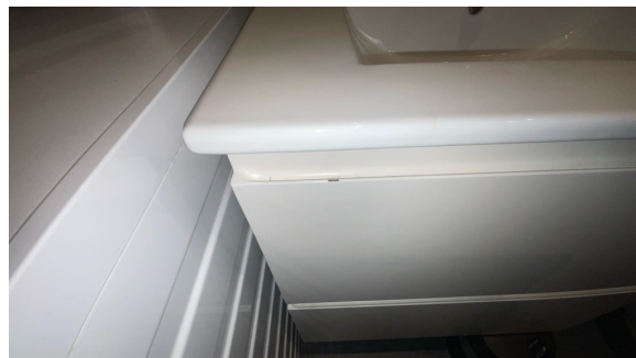
Overflateskade på skuffefront under servant
