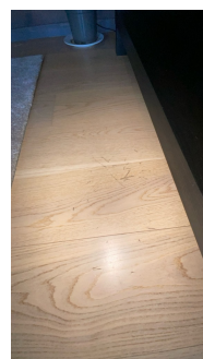
Hakk/skader i parkett foran tv på stue
