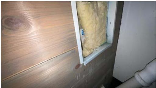
Inspeksjonsluke for utekrane bak vaskemaskin
