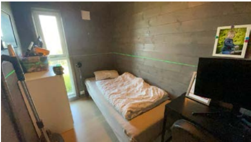
1. etasje. Plassering av laser ved kontroll av soverom. Det er målt 5 mm høydeforskjell gjennom rommet. TG 1
