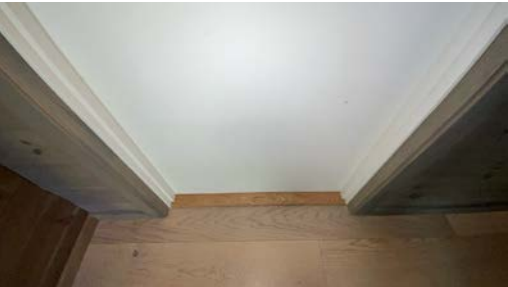
Små overflateskader i dør til bad
