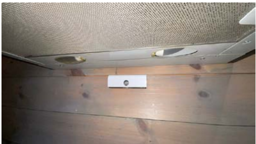
Mangler deksel over lyspære ved befaringen. Deksel er bestilt og vil bli montert så snart det kommer ifølge selger
