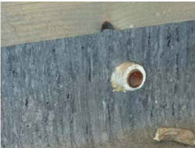
Utløpsrør fra varmtvannsbereder er synlig inne på bad bak vaskemaskin
