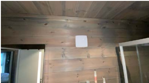
Mekanisk avtrekk på vegg
