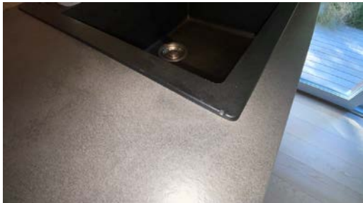
Skade på hjørne av vask
