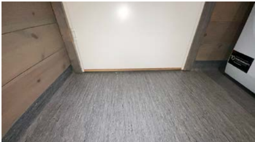
Liten luftespalte under dør
