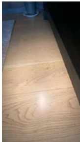
Hakk/skader i parkett foran tv på stue
