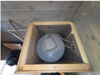
Oversikt varmtvannsbereder som er kledd inn med panel og løst lokk for inspeksjon
