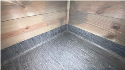
Oppbrett på belegg er løsnet/ujevnhet på yttervegg mot skillevegg
