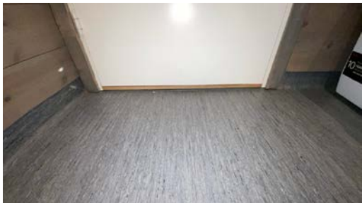
Fuget under dørterskel
