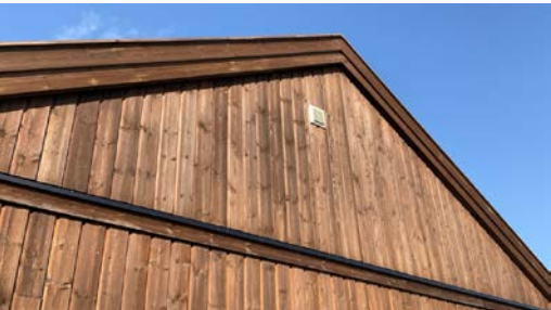
Ventilering av hemsrom over kjøkken via ventil
