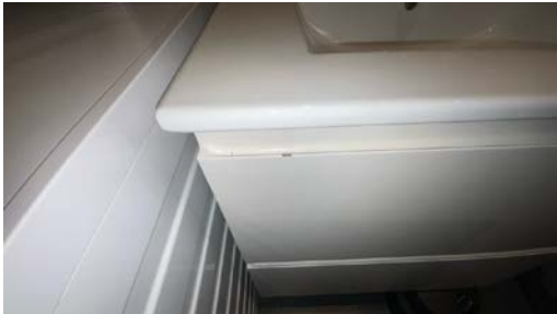
Overflateskade på skuffefront under servant
