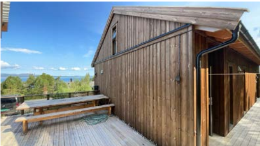
Overflatebehandling av gavelvegg må påregnes
