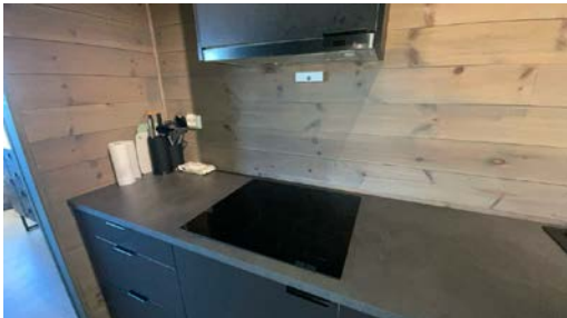
Anbefaler å få montert sikring mot sprut ved platetopp og ved servant
