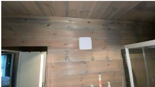
Mekanisk avtrekk på vegg
