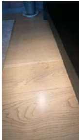
Hakk/skader i parkett foran tv på stue
