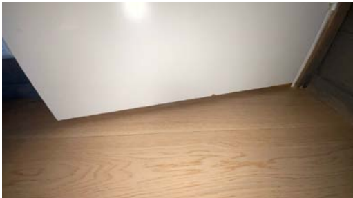
Liten skade på nedre dørblad inne på soverom
