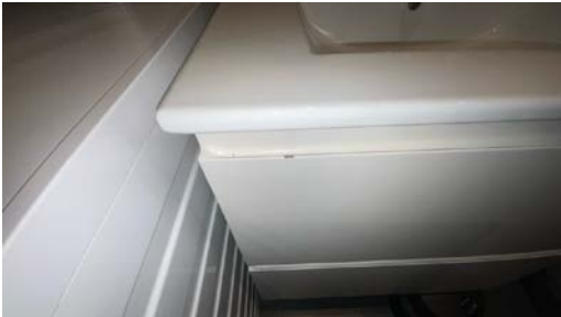
Overflateskade på skuffefront under servant
