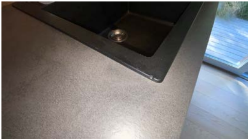
Skade på hjørne av vask
