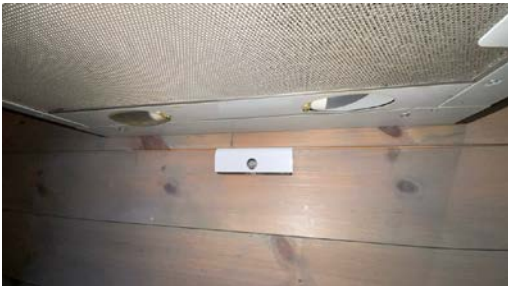
Mangler deksel over lyspære ved befaringen. Deksel er bestilt og vil bli montert så snart det kommer ifølge selger
