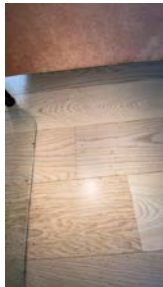
Hakk/skader i parkett foran peisovn på stue
