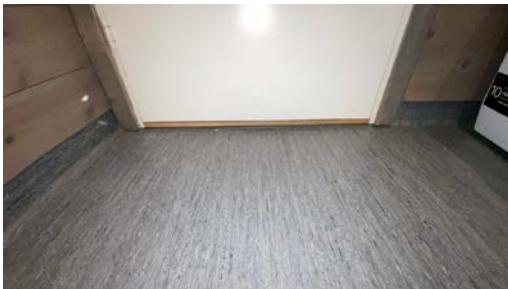
Fuget under dørterskel
