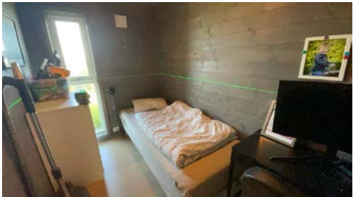
1. etasje. Plassering av laser ved kontroll av soverom. Det er målt 5 mm høydeforskjell gjennom rommet. TG 1
