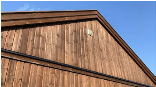
Ventilering av hemsrom over kjøkken via ventil
