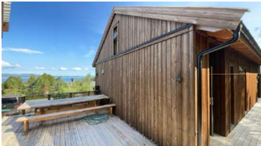
Overflatebehandling av gavelvegg må påregnes
