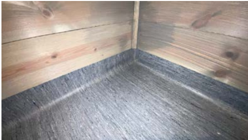
Oppbrett på belegget er løsnet/ujevnhet på yttervegg mot skillevegg
