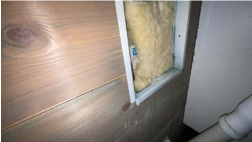
Inspeksjonsluke for utekrane bak vaskemaskin
