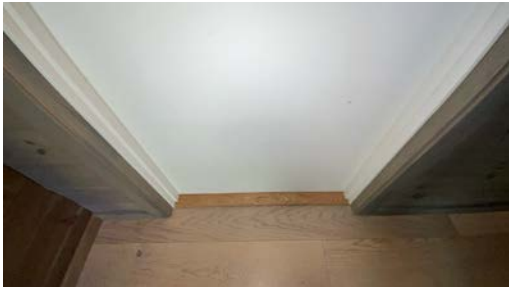
Små overflateskader i dør til bad
