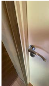
Overflateslitasje på dørkarm bad
