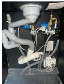
Rørøpplagg i kjøkkenbenk med Waterguard
