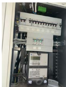
Sikringsskap plassert i felles oppgang.
