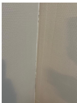
Riss/sprekk i hjørne mellom plater
