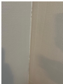
Riss/sprekk i hjørne mellom plater
