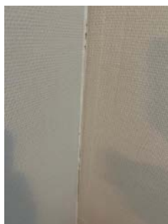
Riss/sprekke i hjørne mellom plater
