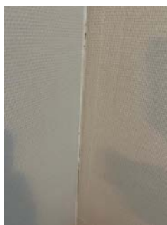
Riss/sprekke i hjørne mellom plater
