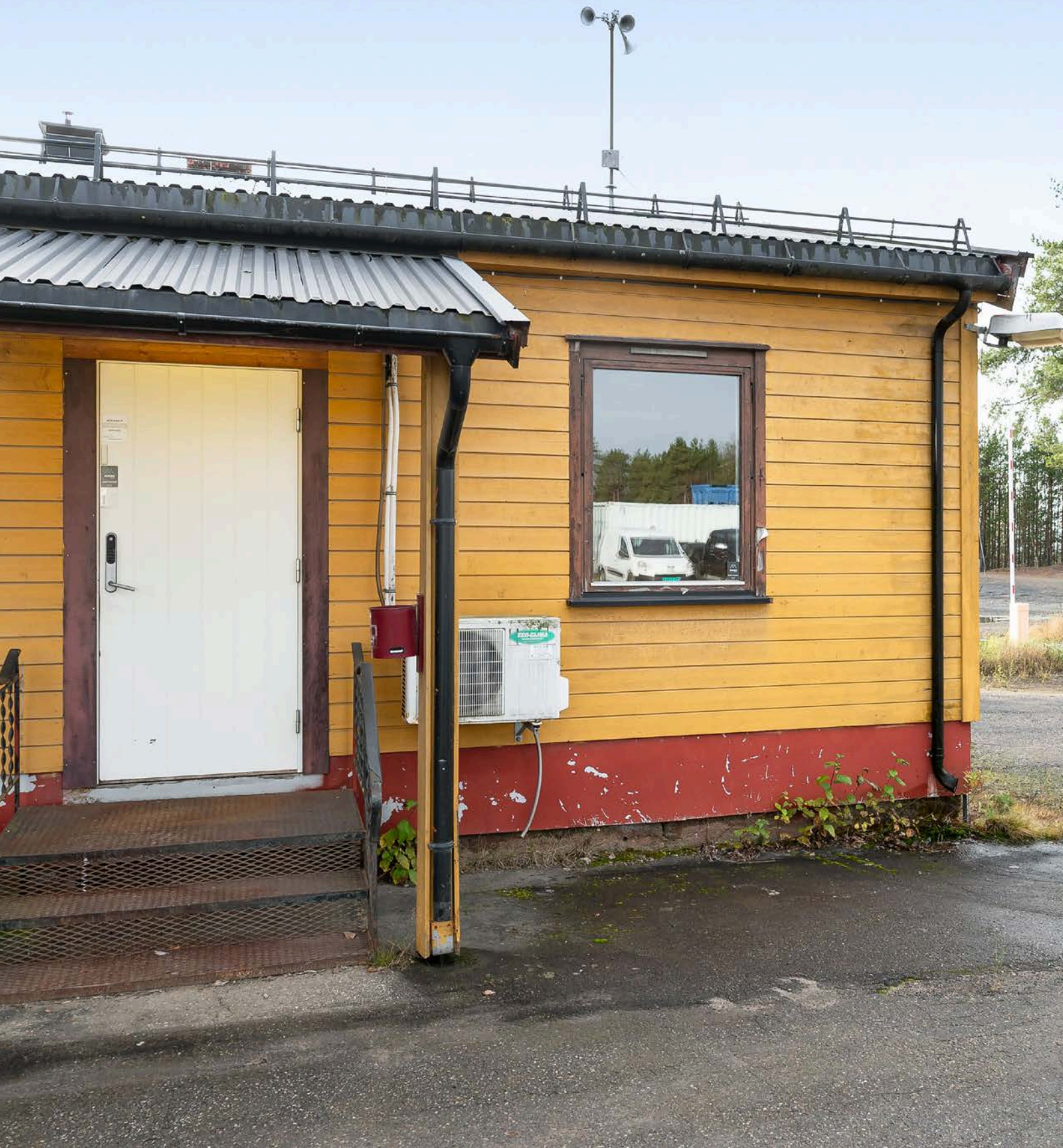
Næringsbygg med normal standard byggeåret tatt i betraktning. Konstruksjoner, overflater og installasjoner med oppgraderings- og vedlikeholdsbehov.
