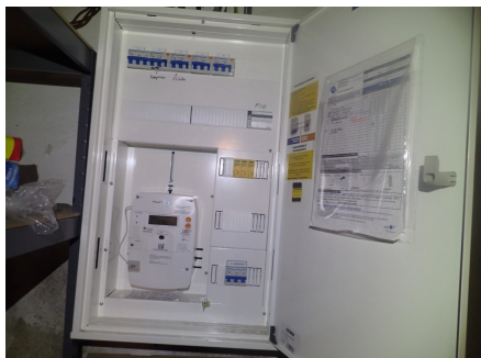
Sikringsskap i kjeller
