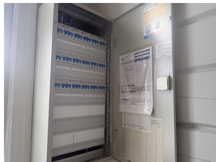
Sikringsskap i 2. etasje
