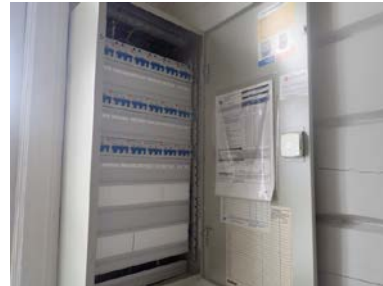
Sikringsskap i 2. etasje
