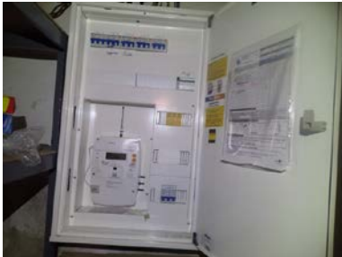
Sikringsskap i kjeller
