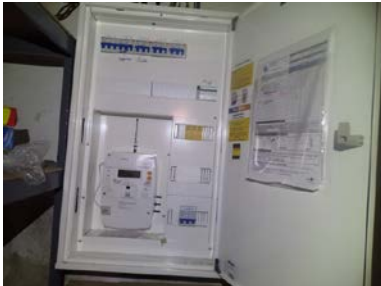
Sikringsskap i kjeller
