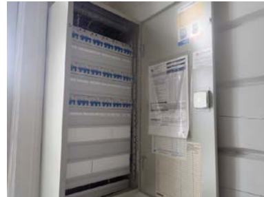
Sikringsskap i 2. etasje
