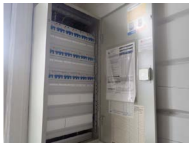
Sikringsskap i 2. etasje
