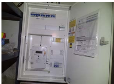
Sikringsskap i kjeller
