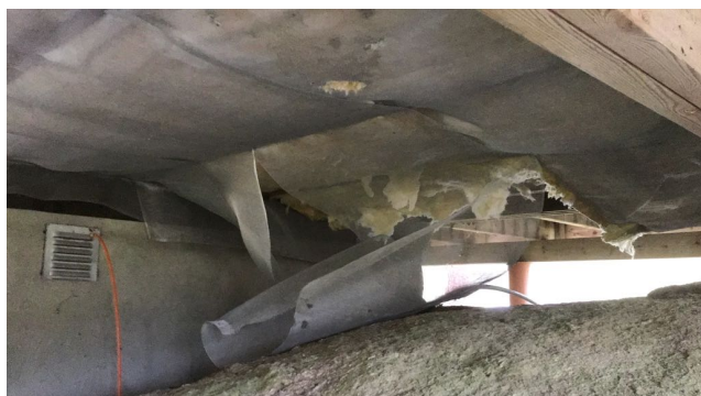
Skader i isolert gulv under Innglasset balkong
