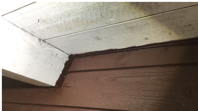
Mangler luftespalte i gesims
