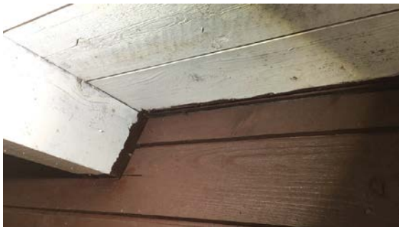
Mangler luftespalte i gesims
