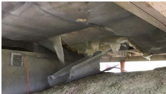
Skader i isolert gulv under Innglasset balkong
