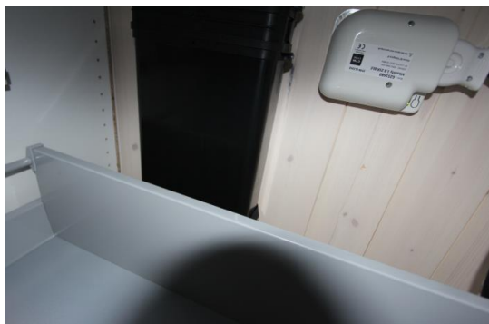
Kanal fra avtrekk.
