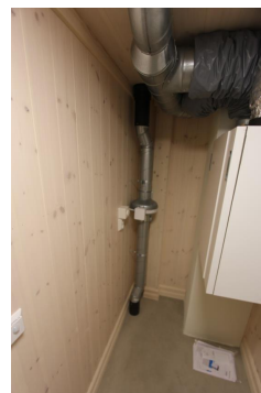
Radon brønn med avtrekk i kjeller.
