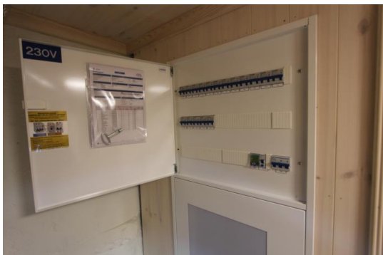
Sikringstavle med automatsikringer.
