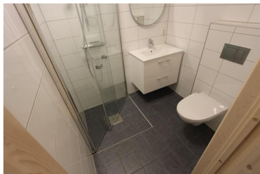
Baderom i andreetasjen.
